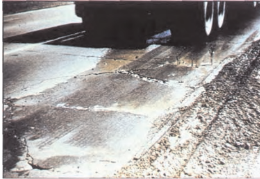
Слика 7.57 Цурење и пумпање воде
