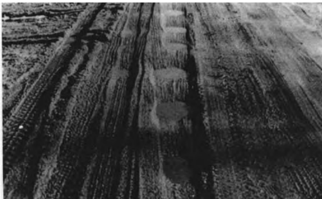
Слика 7.80 Пример наборане коловозне површине средњег нивоа оштећености
