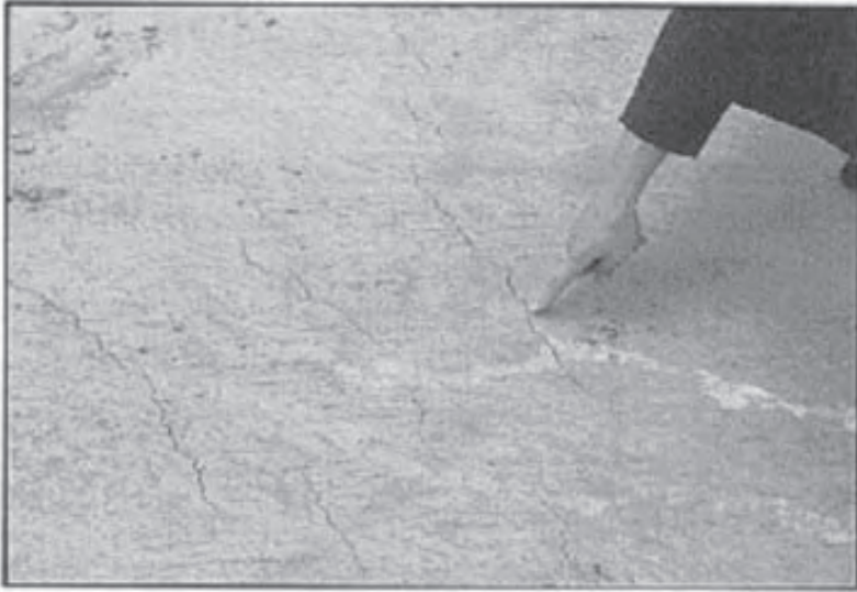
Слика 3.33 Пукотине у бетону настале због његове лоше неге
